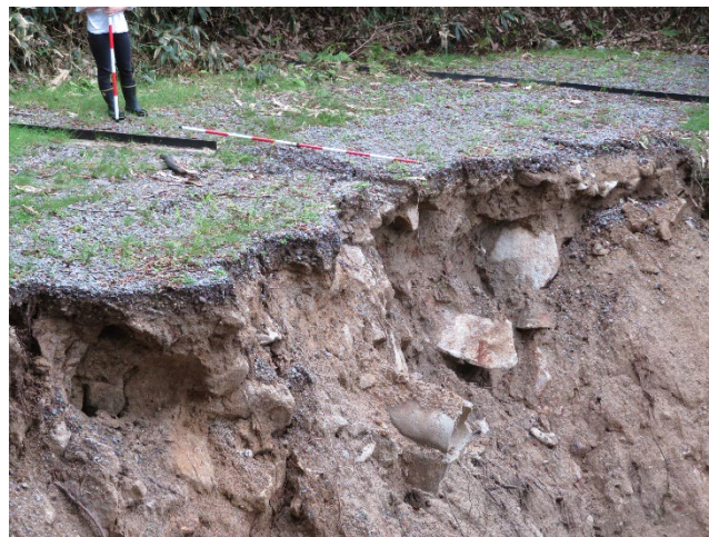
写真1 路肩が崩壊した林道
