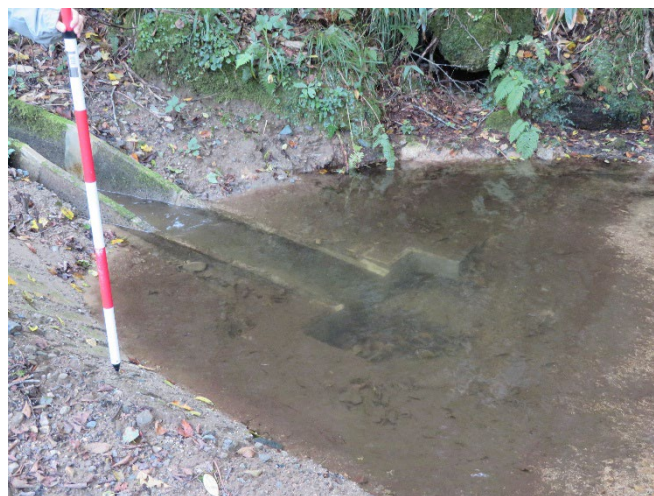
写真2 閉塞した集水桝
