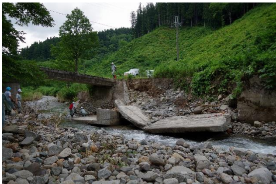
写真1. 護岸擁壁崩壊被害状況
