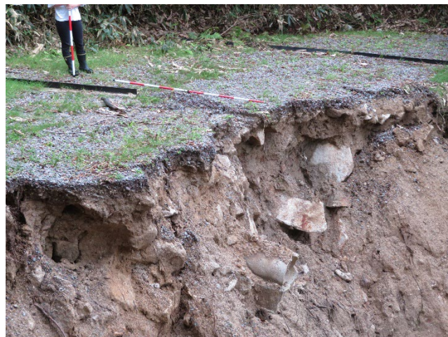
写真1 路肩が崩壊した林道
